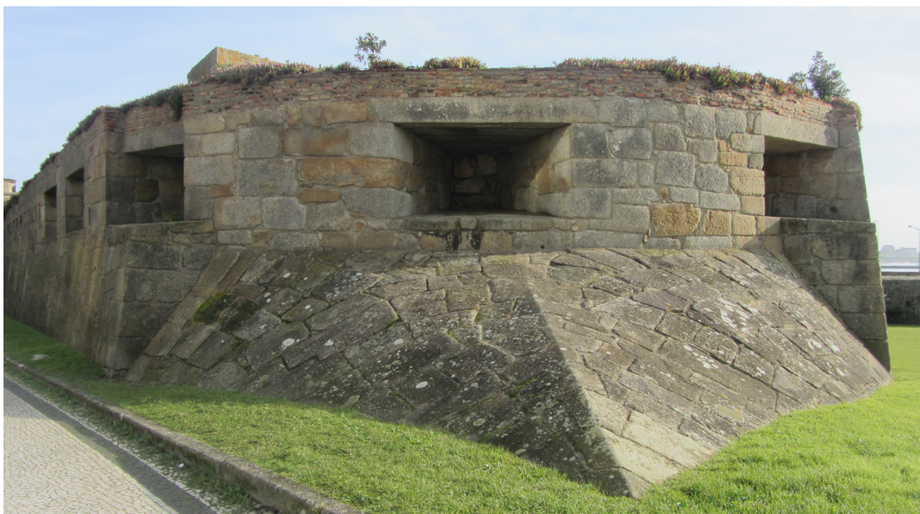
Fig. 75. Forte di Sao Joao Baptista a Porto (Portogallo). Dettaglio del rinforzo alla base (2019).
